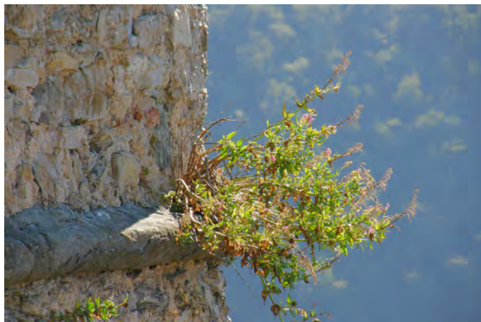
Fig. 18. Torre sud del castello. Vista di una erbacea cresciuta sopra il marcapiano
